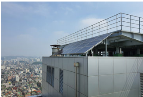
[KB손해보험 합정사옥 태양광 발전설비]
