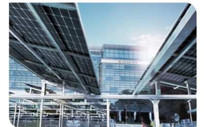
KB증권 연수원 내 태양광 발전설비
